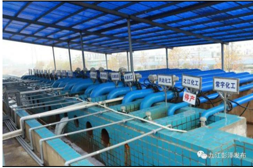
图 12 彭泽县政府严厉监控园区环保
